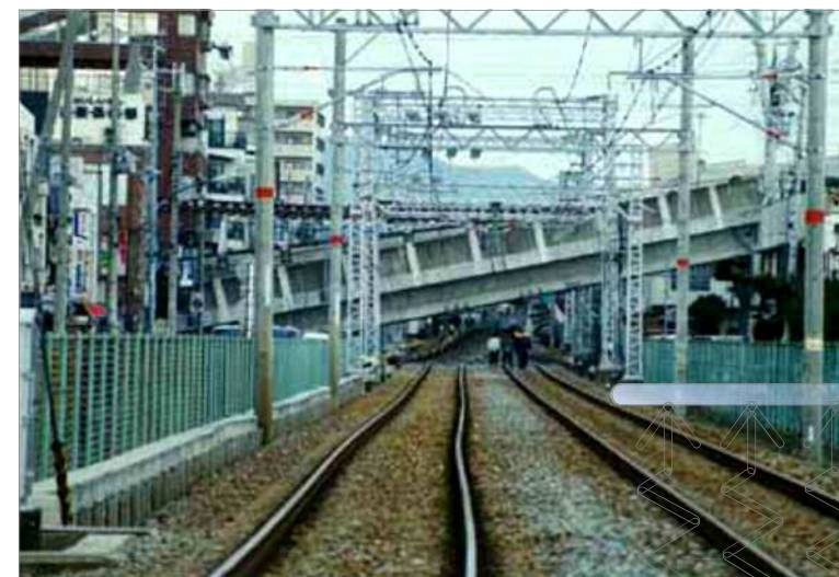
阪神・淡路大震災（1995） 鉄道路線上の桁落下
