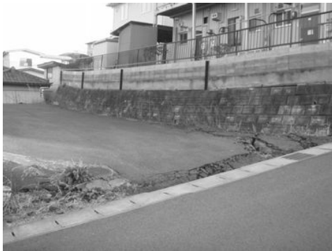
写真4 変動により擁壁が壊れている
