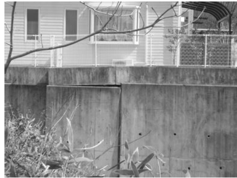
写真6 擁壁部の沈下程度の変状のみ
