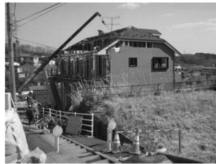
写真7 大きなアパートが傾き、解体中
