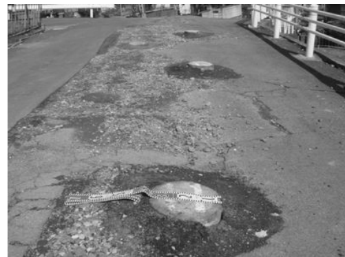
写真1 沈下により道路に突き出た抑止杭
