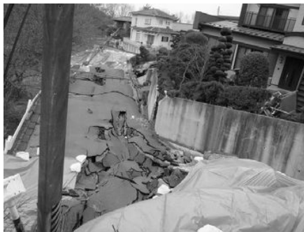
写真9 南側ユニットの崩壊
