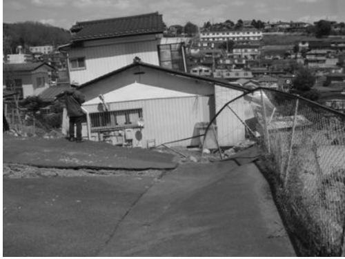
写真3 小規模な腹付け盛土の崩壊
